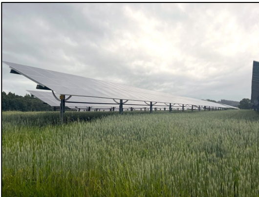
Abbildung 8: Beispiel Agri-PV-Anlage I (Acker)
