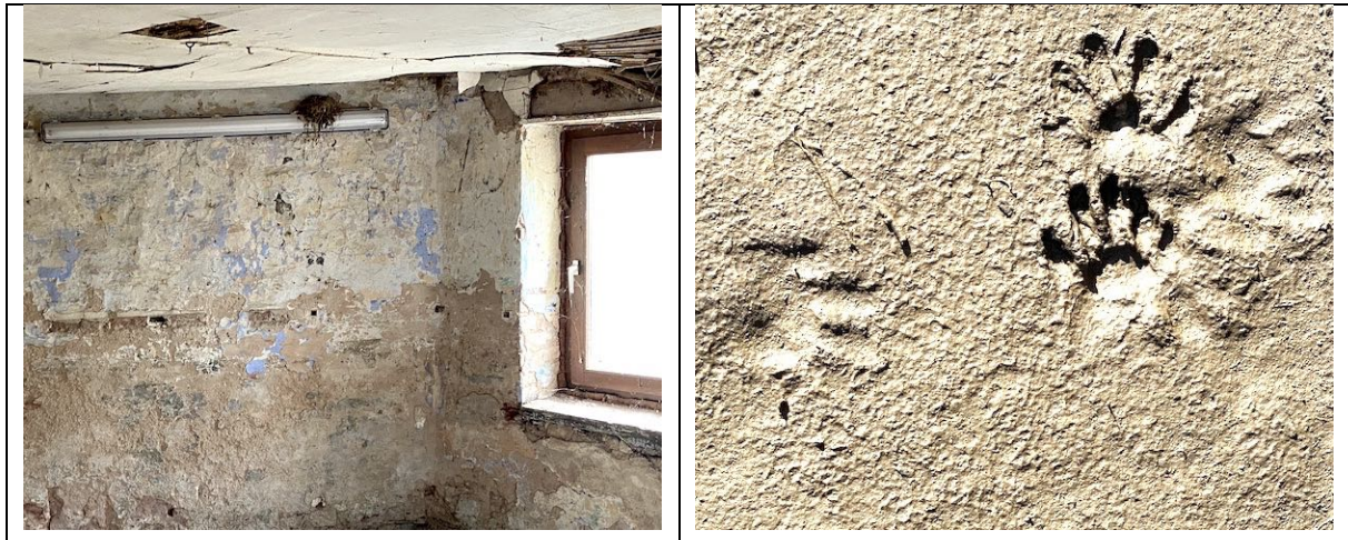
Abbildung 5: Amselnest in einem Magazinraum, verschieden alte Waschbärsiegel in Pfütze
